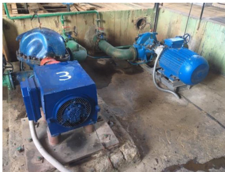
Рисунок 1.1.8 – Насосные агрегаты станции
