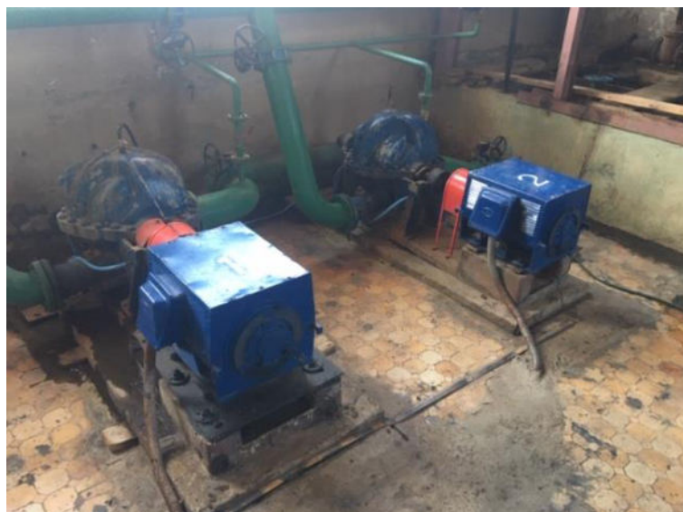
Рисунок 1.1.7 - Насосные агрегаты станции
