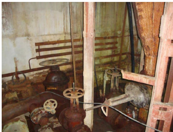
Рисунок 1.1.10 - Вихревой смеситель и арматура на водоводах от НС-I
